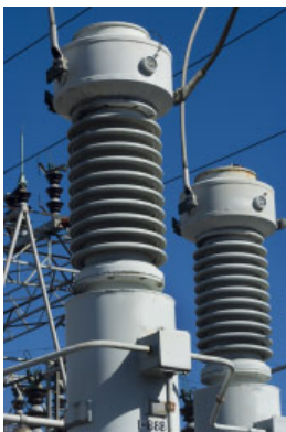
Transformateur de courant Haute Tension
