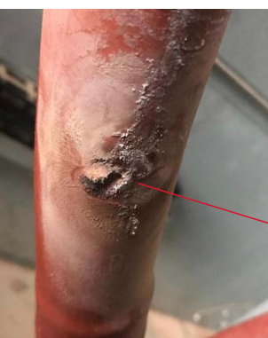
Scénario de cas réel: décharge partielle détectée sur une terminaison de câble.
